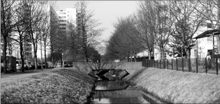
Hier ist Sauberkeit auch Flutschutz: Die Entwässerungskanäle sollen künftig verstärkt gereinigt werden
