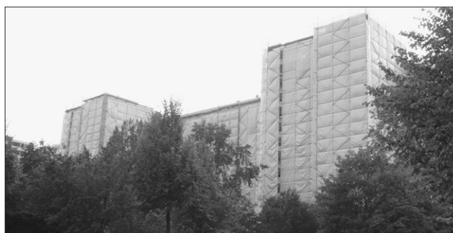
Auch wenn es an den eingepackten Reichstag erinnert: Das 14-stöckige Baugerüst in Kirchdorf-Süd ist kein Kunstwerk von Christo
